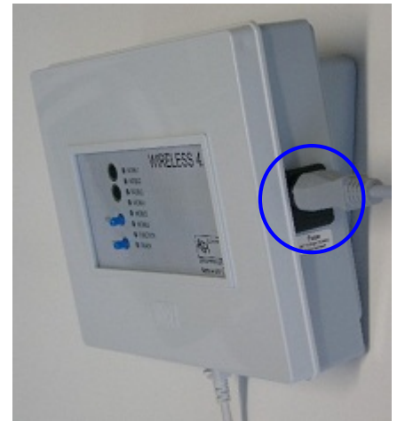
Position der Netzbuchse an der Mainstation W4.2
